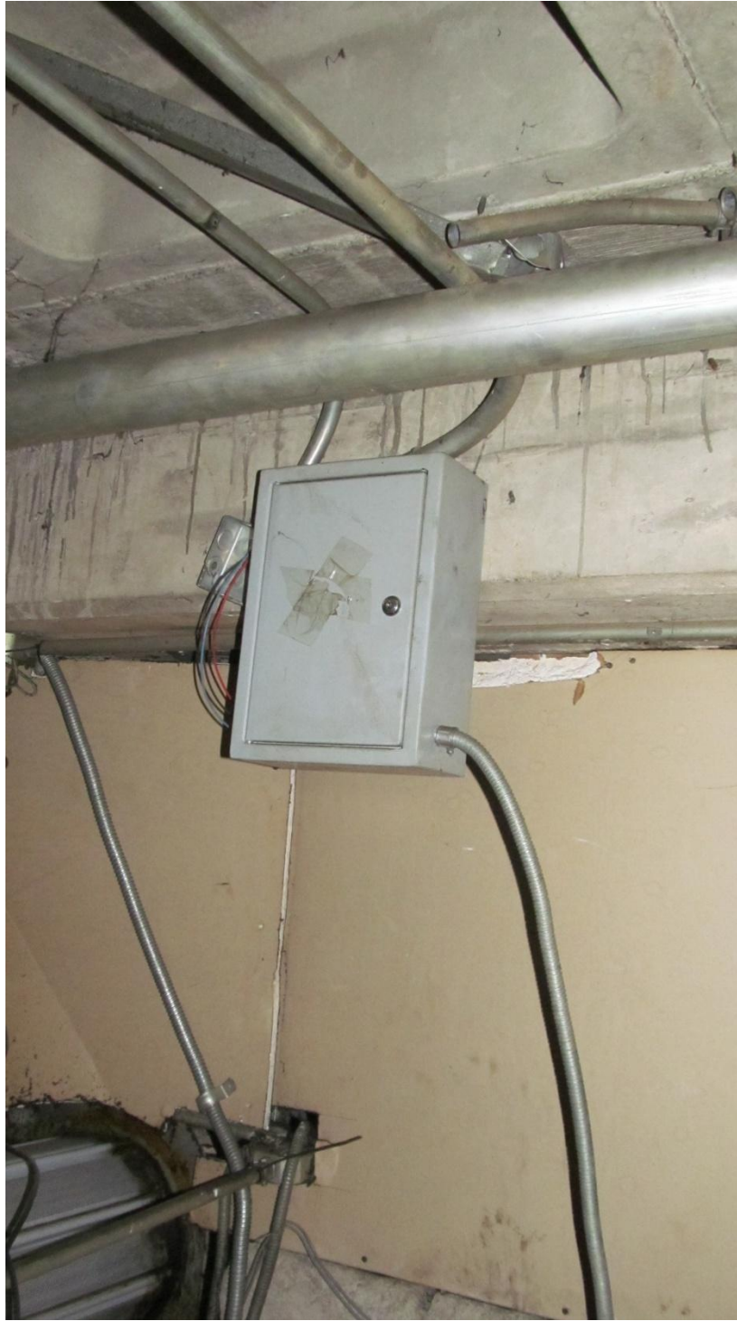
Anexo 2 - Tablero 1: Ubicación antigua
