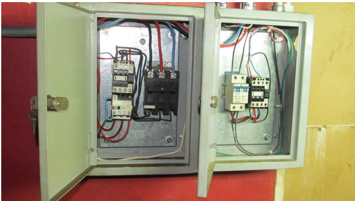
Anexo 11 – Tableros eléctricos con componentes
