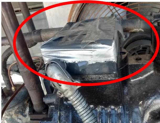
Anexo 1: Caja de la bornera del motor compresor
