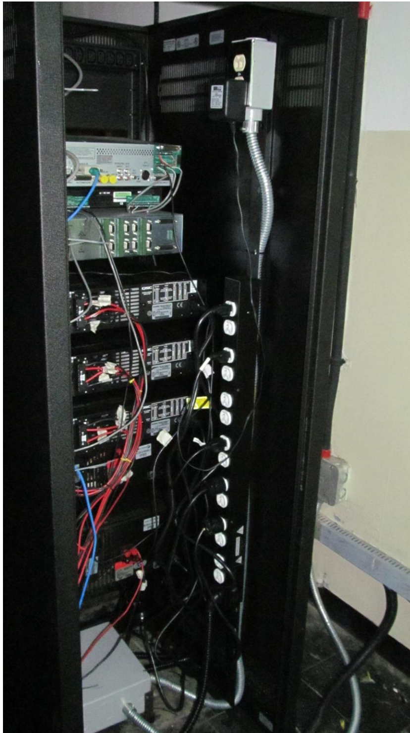
Anexo 2 – Rack de sonido: Instalación
