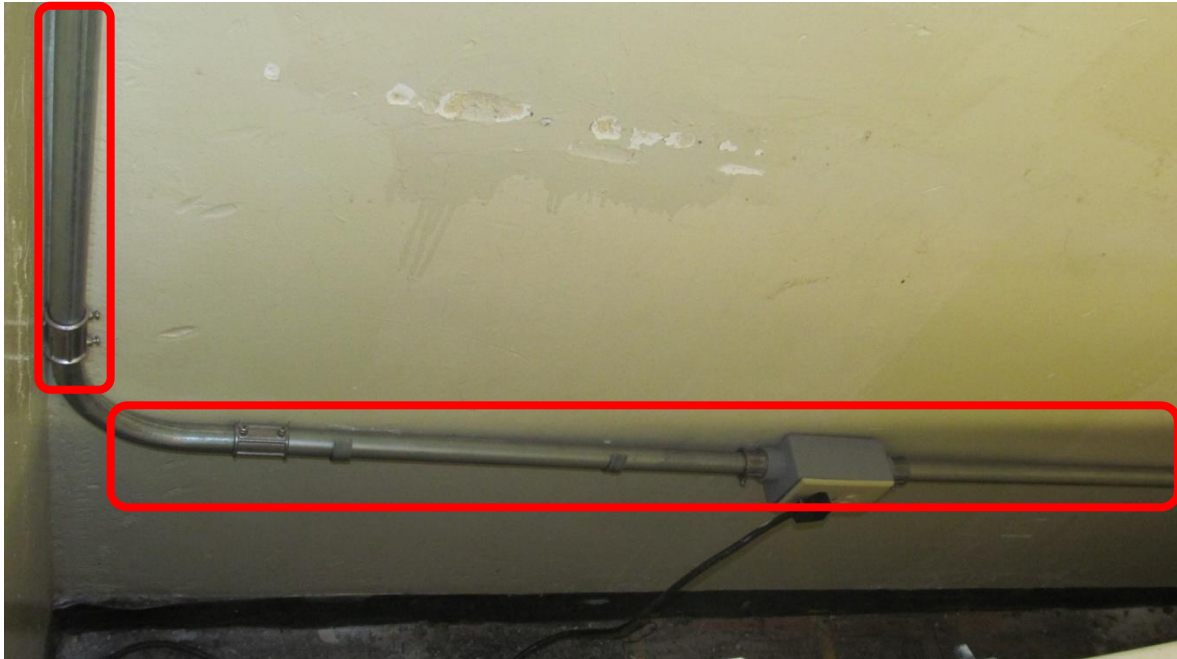
Anexo 7 – Acometida eléctrica ACTUAL : Trayecto 2 y 1ª caja condulet
