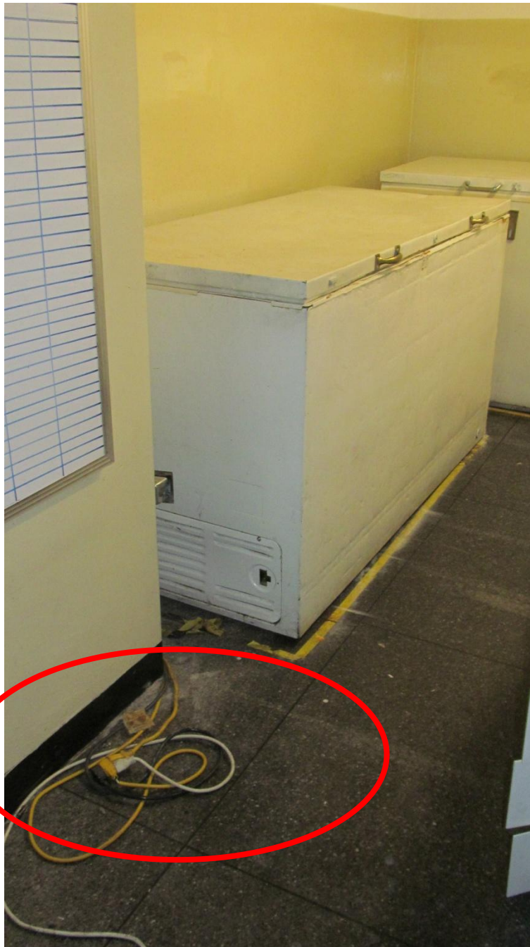
Anexo 4 Instalación Antigua: Extensión improvisada desde tomacorriente.
