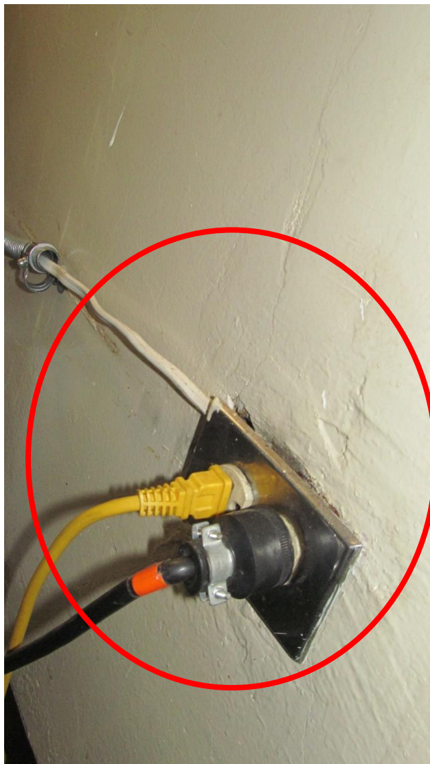
Anexo 3 - Instalación Antigua : Extensión improvisada desde tomacorriente.
