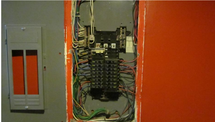
Anexo 1 - Instalación Antigua : Tablero eléctrico.
