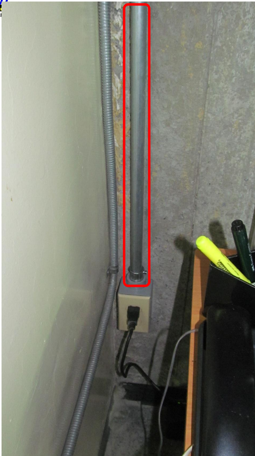
Anexo 12 – Acometida eléctrica ACTUAL : Trayecto 7 Ramificación hacia PC y caja condulet.
