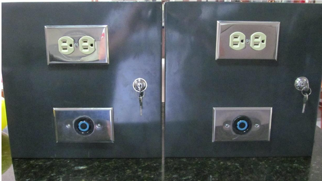
Anexo 1: Tablero – Cara frontal
