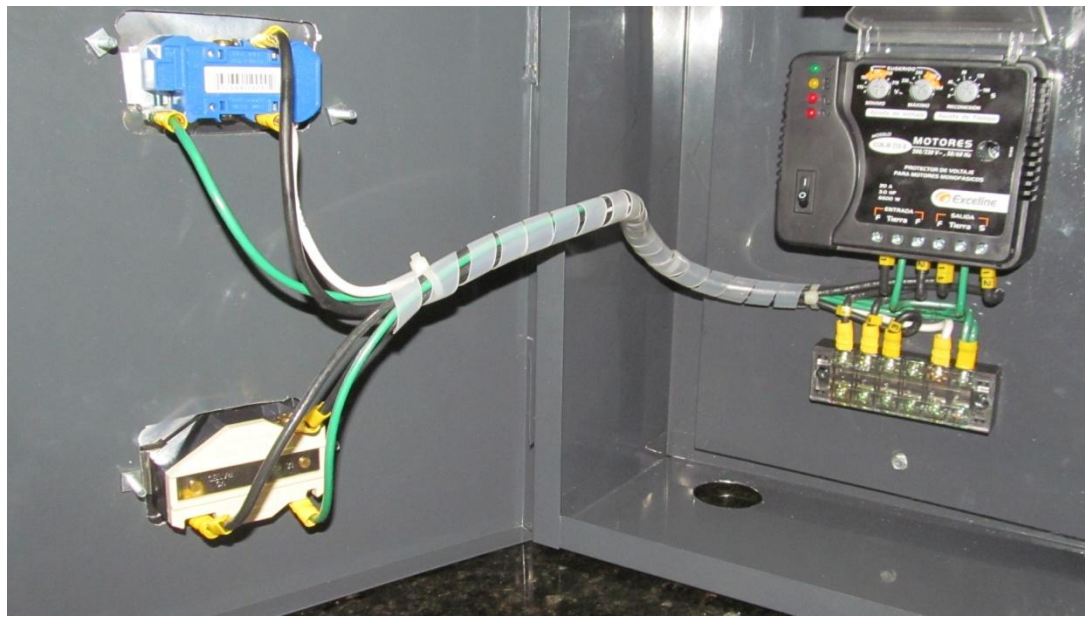
Anexo 2: Tablero – Lado Interno (Supervisor de fase, bornera, conexiones en tomacorriente 270 cooper y NEMA L6)
