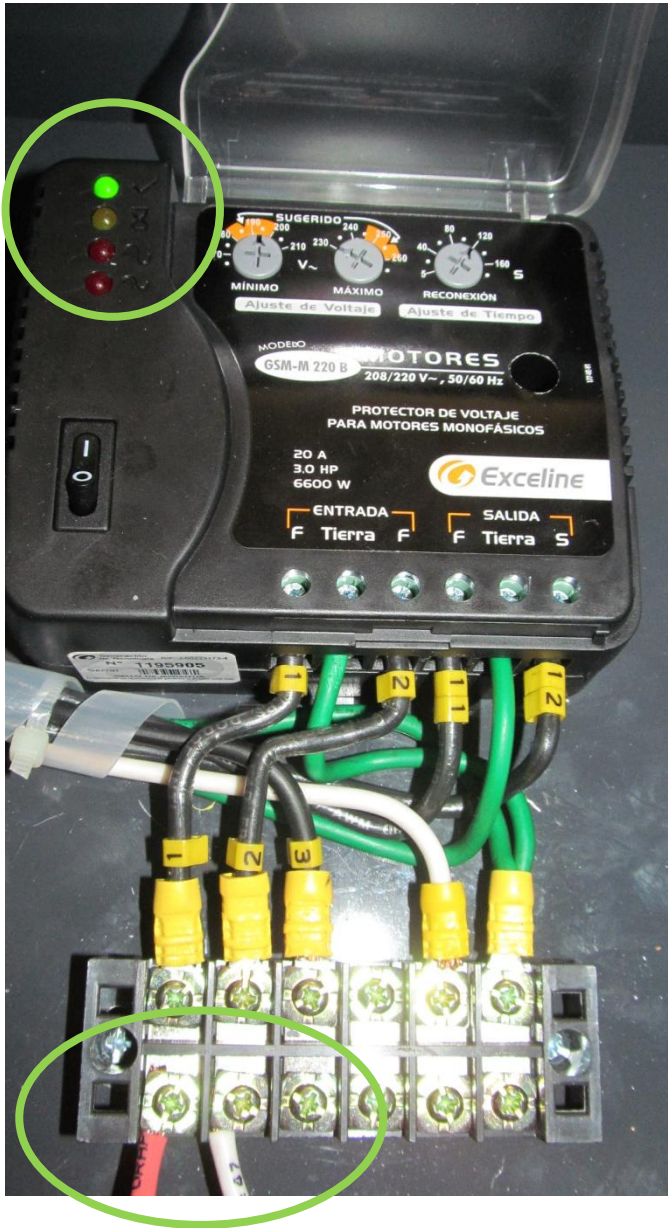
Anexo 4: Tablero – Prueba de funcionamiento Tablero 1. (Alimentación y led de arranque en supervisor de fase)
