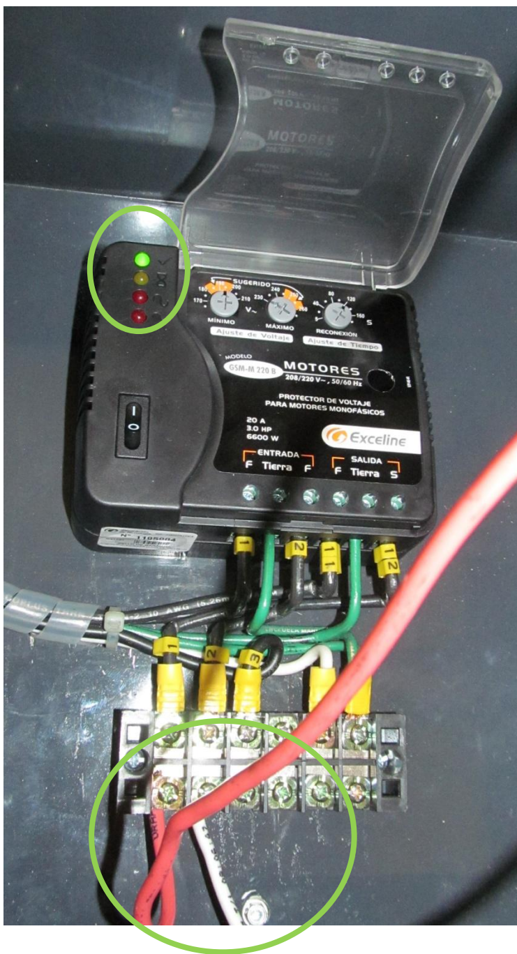
Anexo 5: Tablero – Prueba de funcionamiento Tablero 2. (Alimentación y led de arranque en supervisor de fase)
