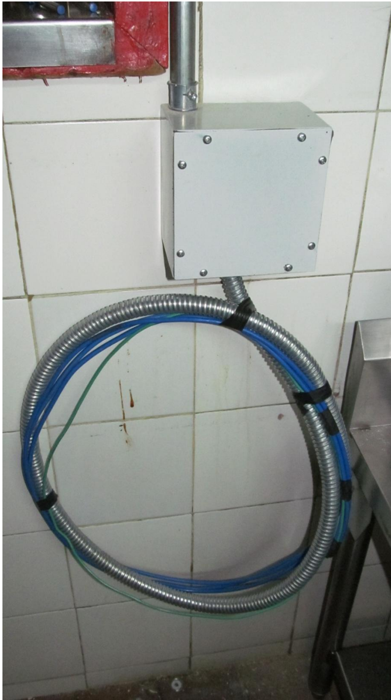
Anexo 8 – Acometida eléctrica 208V: Caja de paso y tubería flexible para conexión al equipo.
