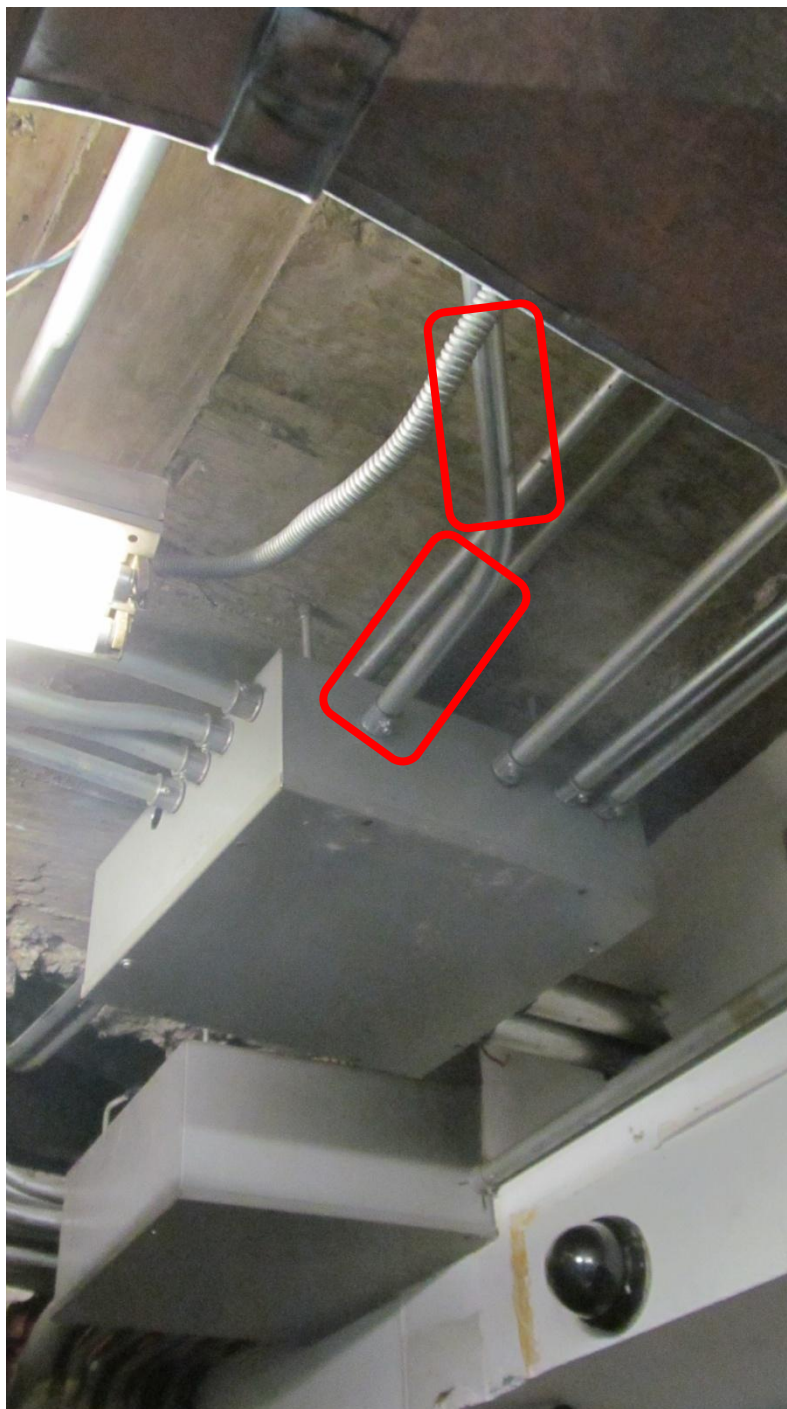
Anexo 6 – Acometida eléctrica 208V: Ramificación hacia sobre techo
